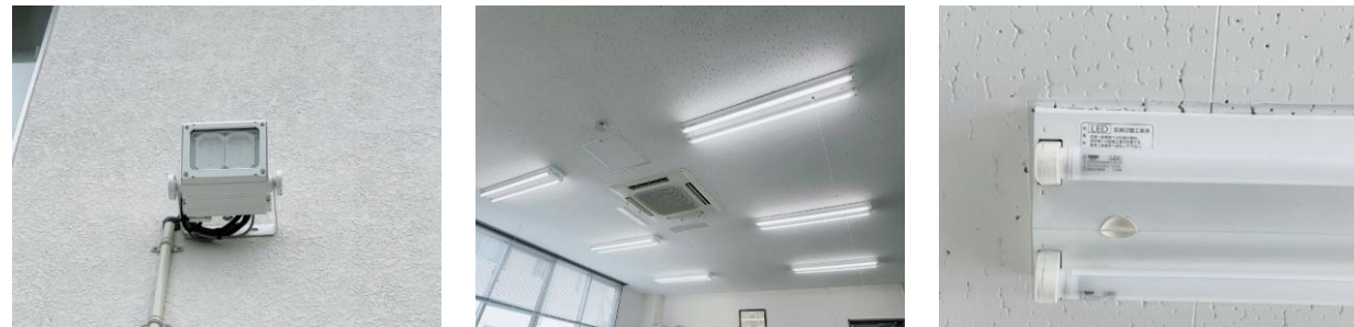
写真2 飯塚支所におけるLED工事後の各種設備
