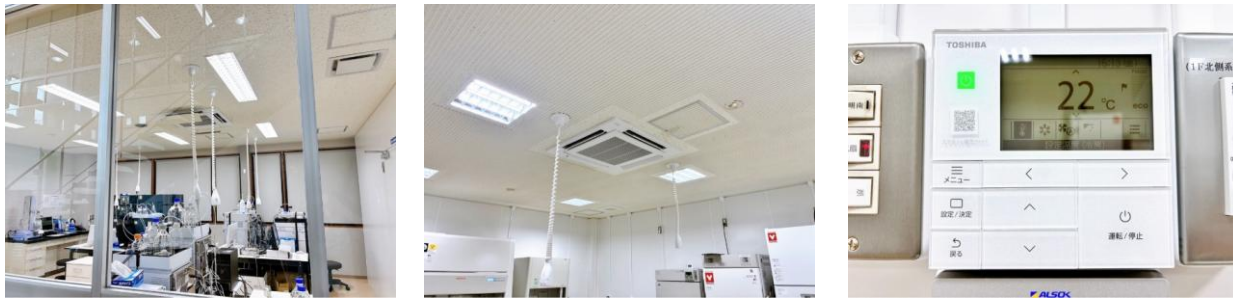
写真1 更新された医薬品試験室系統の空調設備
